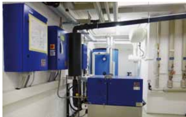
Kehler Straße 38 (vorher und nachher) sowie das Blockheizkraftwerk
