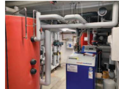
Blockheizkraftwerk Sonnenstr. 1, Freiburg
