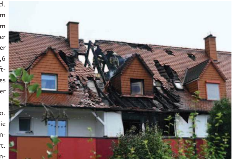
Brandschaden Johannisbergstr. 18, Freiburg
